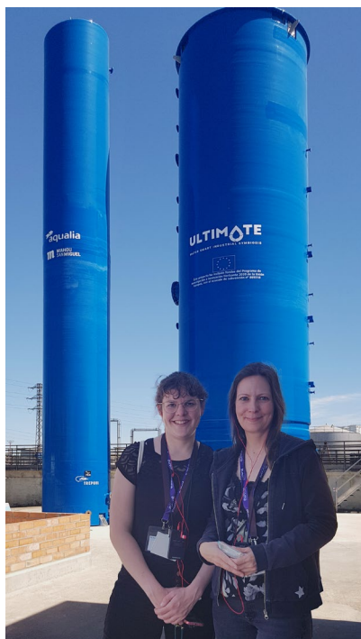
Lea Conzelmann (links) und Projektleiterin Dr. Anne Kleyböcker (rechts) vor der sich im Bau befindlichen ELSAR-Anlage in Lleida (Spanien)
