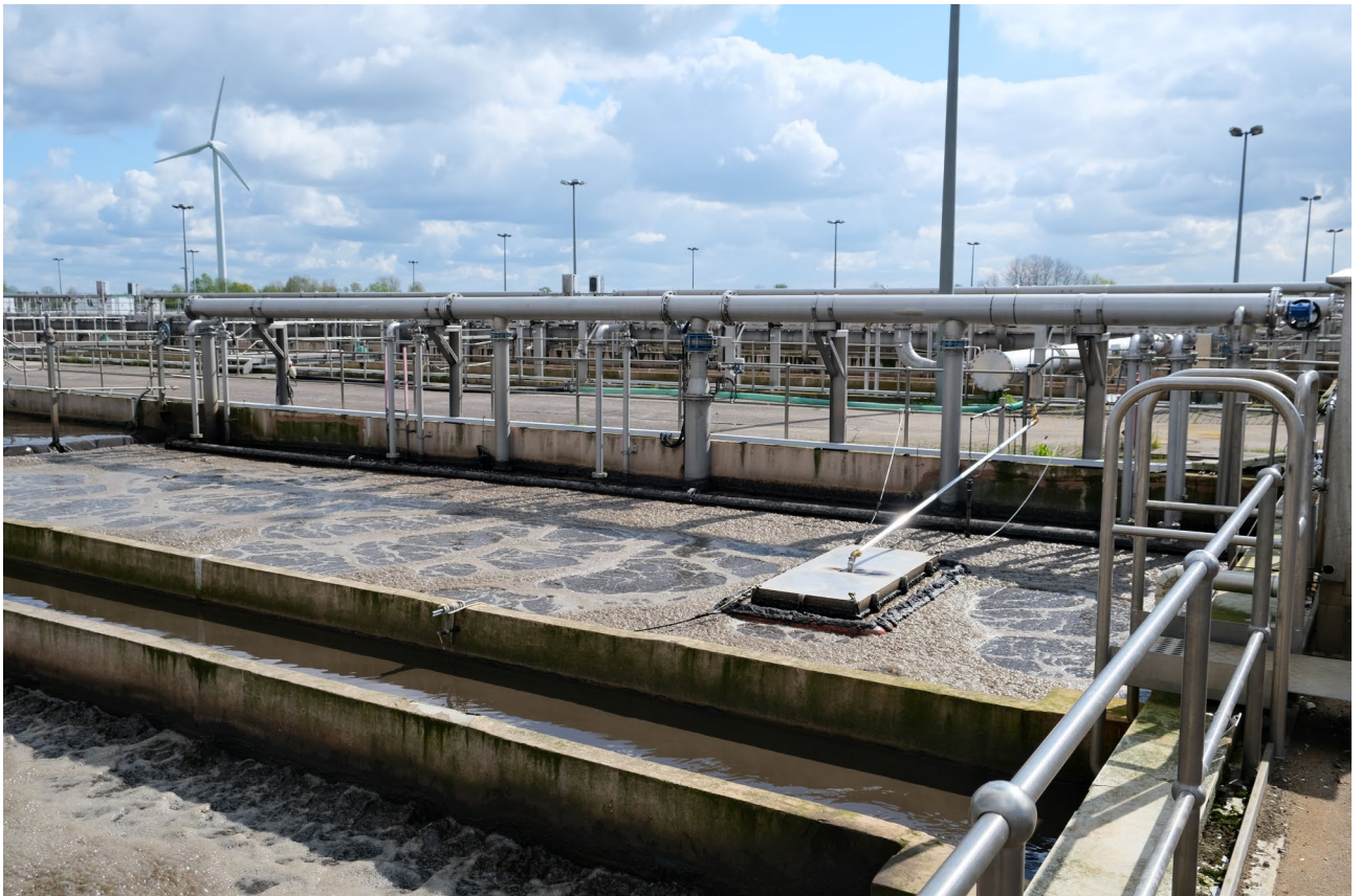
Haube auf Zone 0 der Halblinie 3.2 in Schönerlinde (Reingasmessstelle)
