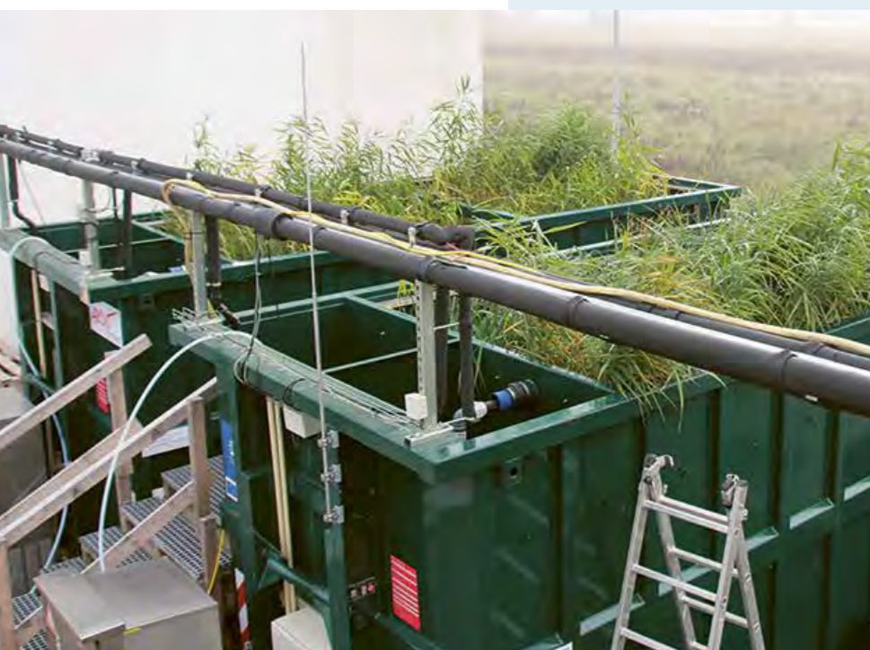
Demonstrationsanlage bewachsener Bodenfilter in Containerbauweise
