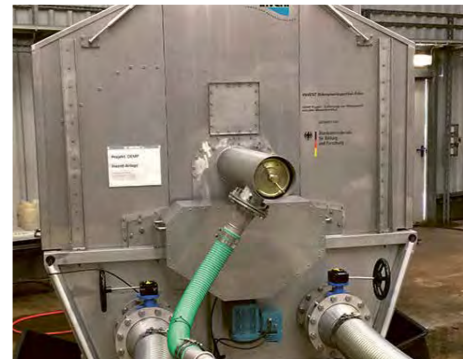
Versuchsanlage Polstofffilter am Standort des Klärwerks Ruhleben, Berlin
