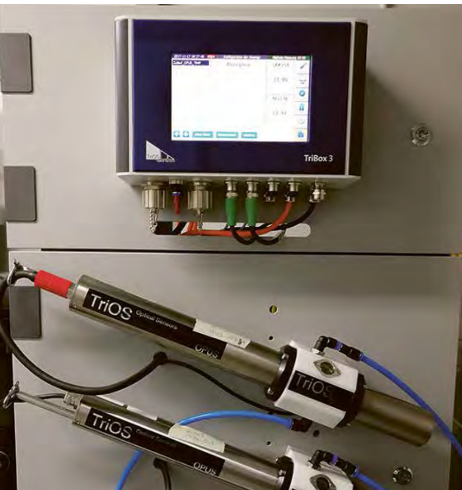
UV-VIS-Sonden im Betrieb der Ozon-Pilotanlage
