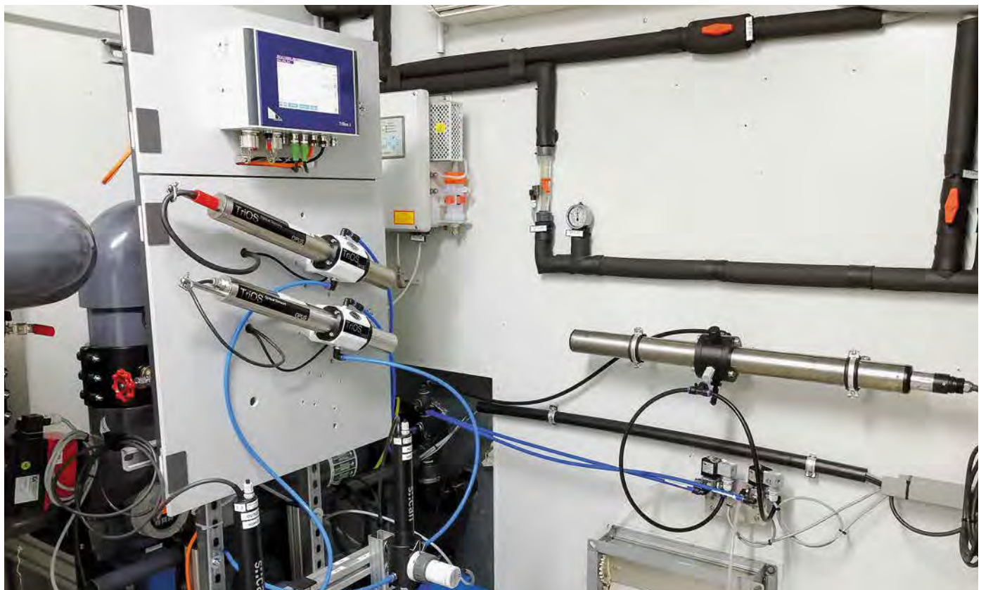
UV-VIS-Sonden im Betrieb der Ozon-Pilotanlage
