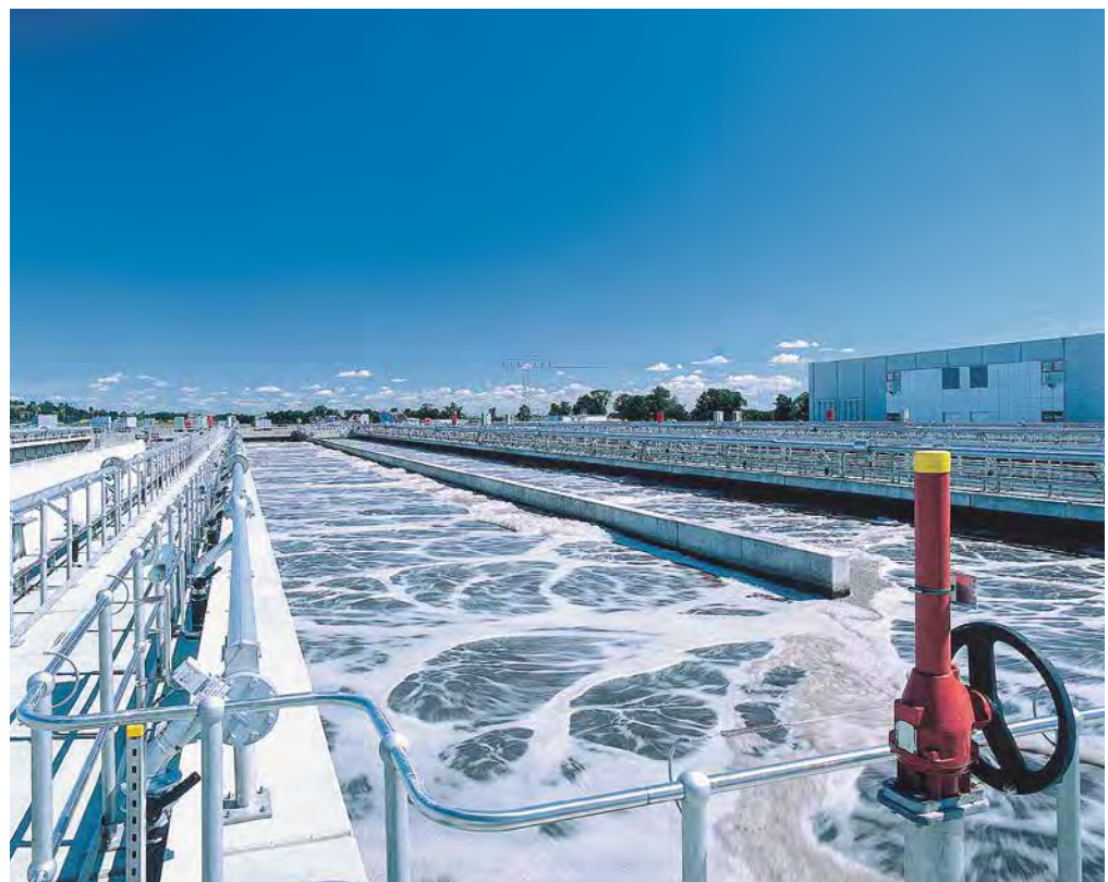
Klärwerk Waßmannsdorf der Berliner Wasserbetriebe
