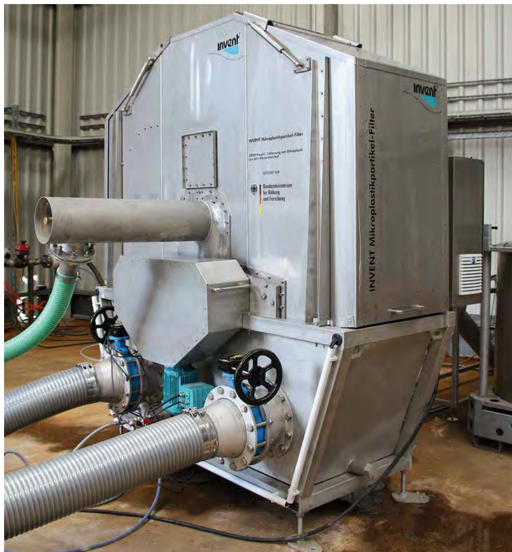
Versuchsanlage Polstofffilter am Standort des Klärwerks Ruhleben, Berlin
