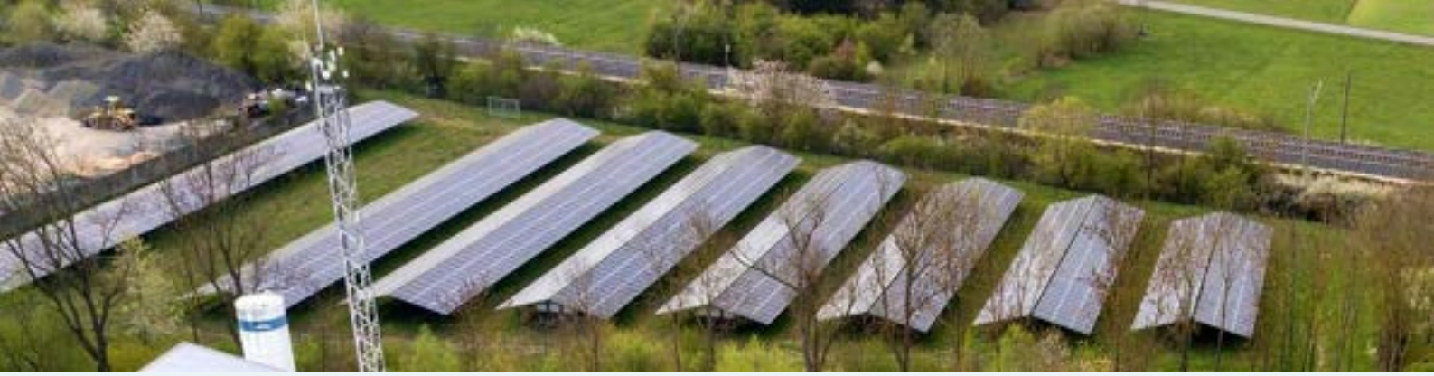
Die Photovoltaik-Anlage ist ein fester Bestandteil der eigenerzeugten Energie in Haßfurt | Quelle: Stadtwerk Haßfurt GmbH (Instagram/@stadtwerk_hassfurt)
