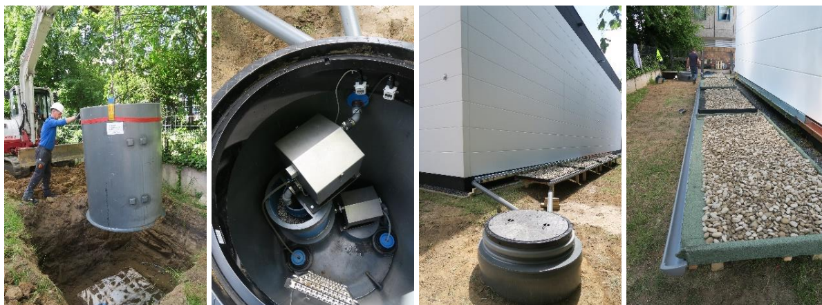
Abbildung 14: Pilotinstallation des Regenfilters, an den 150 m 2 Fassadenfläche mit Abflussrinnen aus Zink und Kupfer, zwei Testflächen mit Bitumenbahnen sowie zwei Testflächen mit EPDM-Bahnen angeschlossen sind.
