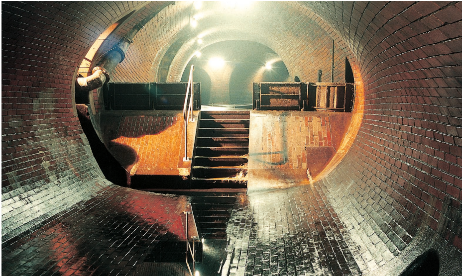
Stauraumkanal, Seestraße, Berlin (Quelle: Berliner Wasserbetriebe)
