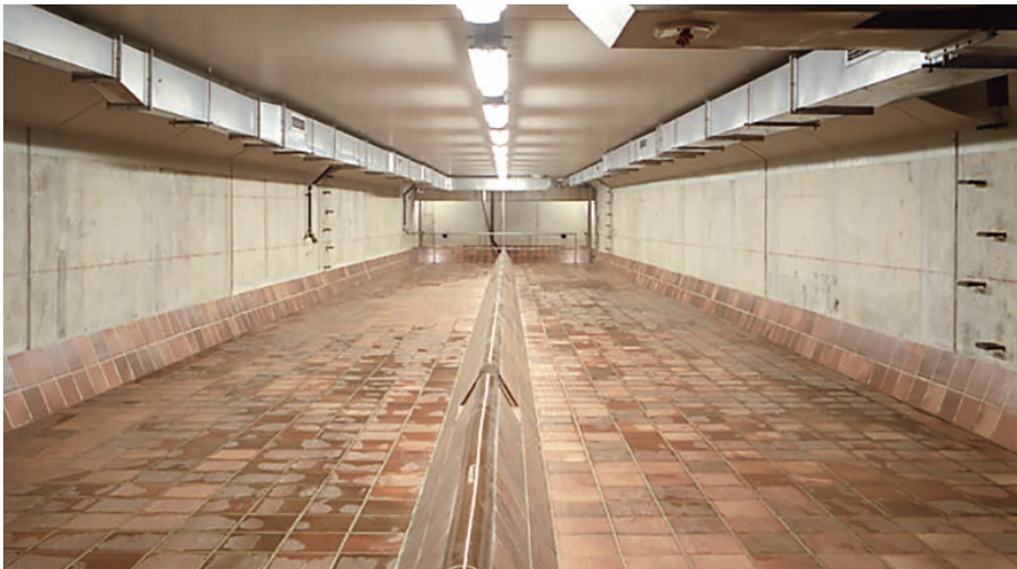
Regenklärbecken, Badeweg, Berlin (Quelle: Berliner Wasserbetriebe)
