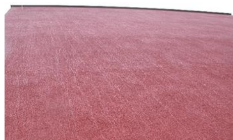
Schlagregen an einem Gebäude (© OST)
