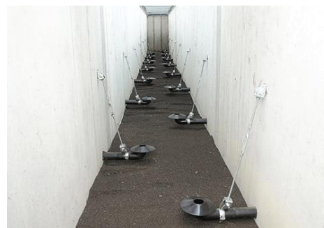
Semizentrale Behandlungsanlage (© OST)
