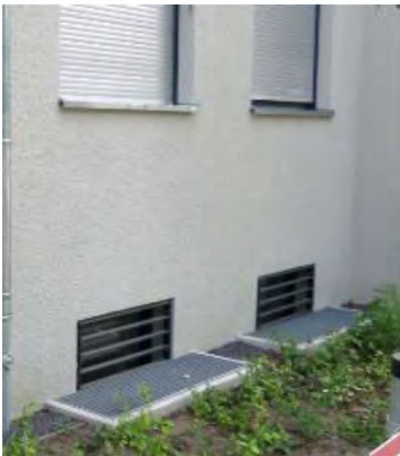
Abbildung 58: Über Lichtschächten befindliche verzinkte Fensterbänke in Testgebiet B
