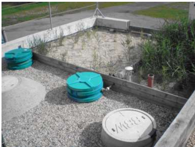
Abbildung 23: Pflanzenkläranlage Typ UFZ C+H 4 E in der Demobox BDZ Leutzsch
