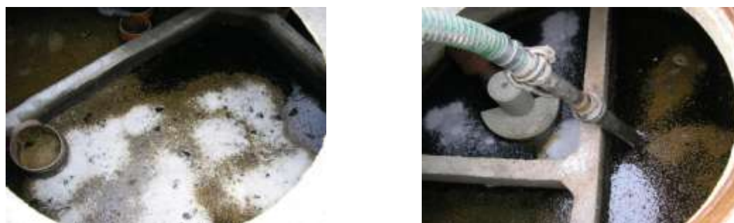
Abbildung 43: Ölhavarie – Ölbindemittel in den Anlagen
