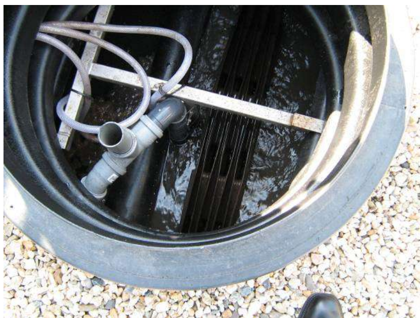
Abbildung 10: Photo, Anlage im Betrieb (BDZ Leipzig)
