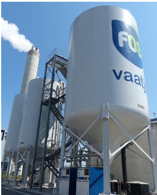
Abbildung 3: Struvitreaktoren der Kläranlage Amsterdam-West
