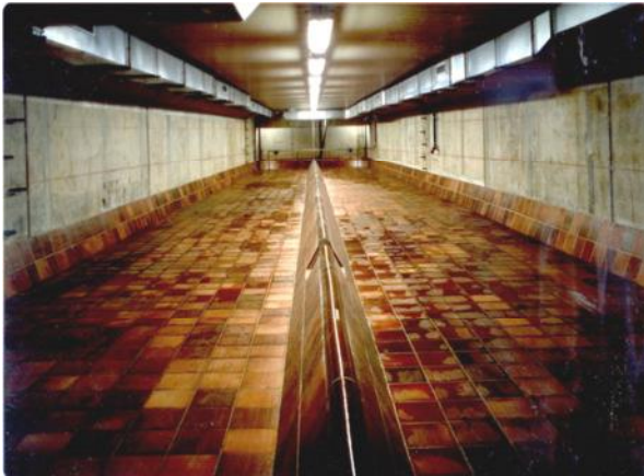
Leeres Regenklärbecken (Foto: BWB)
