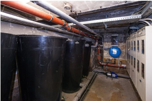
Regenwassernutzungsanlage Weiberwirtschaft, Zisternen (Foto: Andreas Süß)
