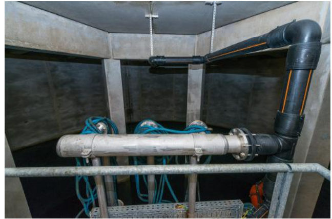
Zisterne zur Regenwassernutzung, Olympiastadion Berlin (Foto: Andreas Süß)
