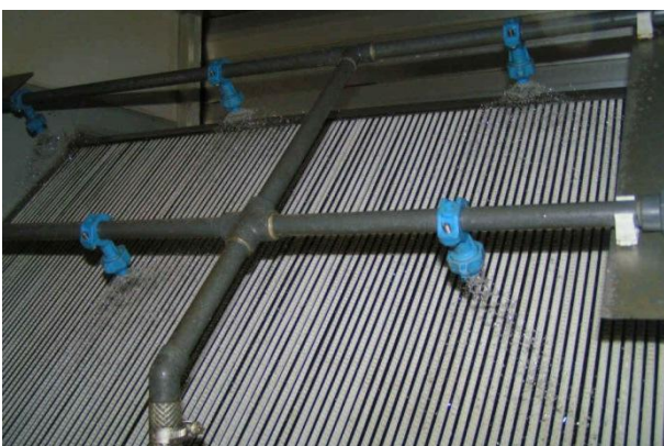
Adiabate Abluftkühlung mit Regenwasser (Foto Marco Schmidt)
