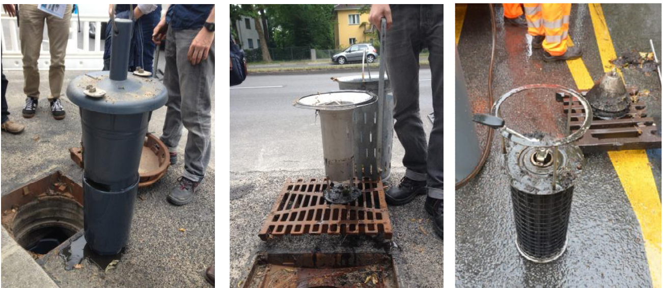
Verschiedene Systeme der dezentralen Regenwasserbehandlung an der Clayallee Berlin (Fotos: KWB, Sieker)
