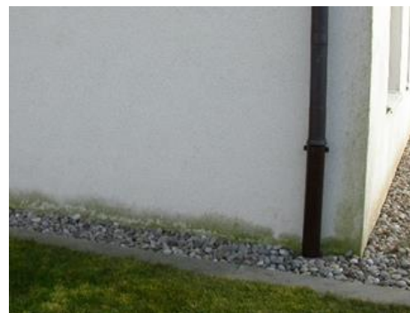
Algenbewuchs durch Spritzwasser (© OST)
